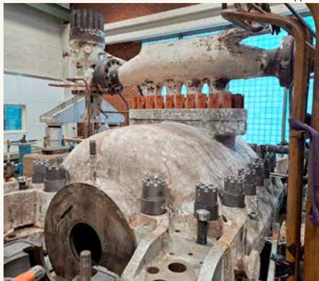
Kuvassa höyryturbiinin ulkopesä ja pikasulkuventtiilit täyshuollon aikana lokakuussa 2023.
