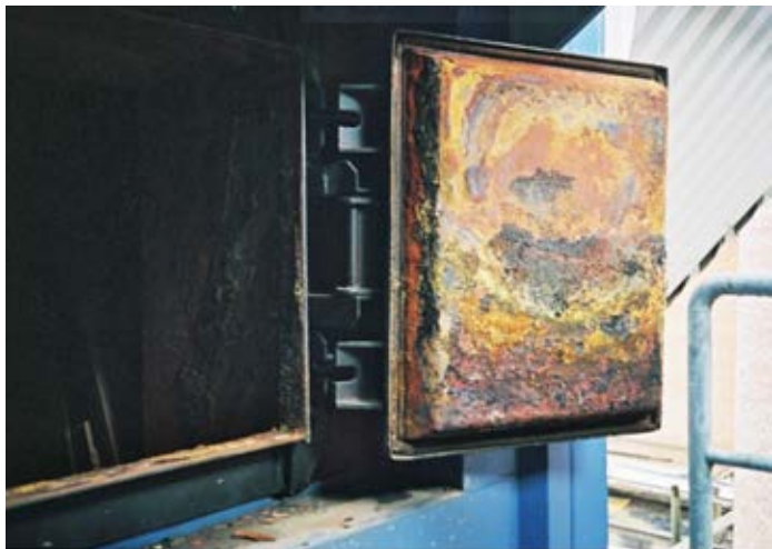
Ilmavuotojen vaurioittaman tarkistusluukku
