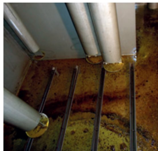
Pohjasakkaa oli kertynyt varsin voimakkaasti säiliöpohjalle
