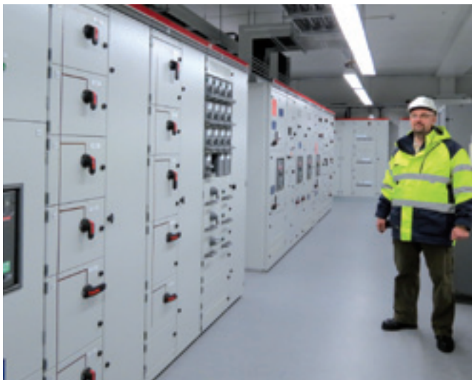
Sähkökeskus missä Markku Ojansuu opastaa
